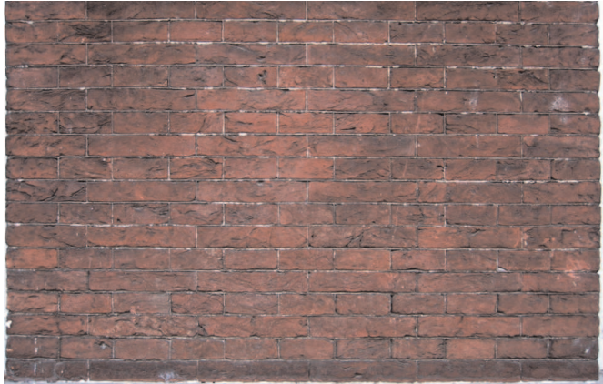
Afb. 20. Rapenburg 65 te Leiden uit 1749 met een drieklezoer als hoekoplossing (foto E. Orsel).
