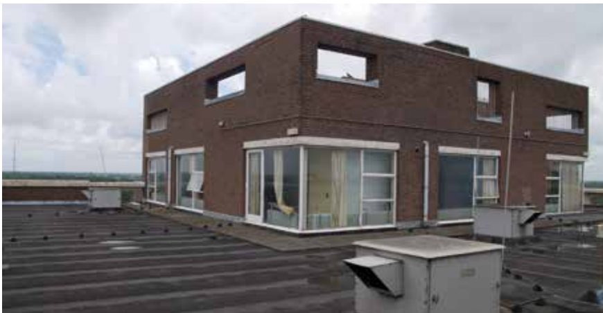
De terugwijkende dakopbouw op de toren, waarin de liftinstallatie is verwerkt en twee appartementen. Bovenop ligt een dakterras met kijkkasten. De drie bakken ten behoeve van luchtverversingsinstallaties rond de dakopbouw zijn later aangebracht.
