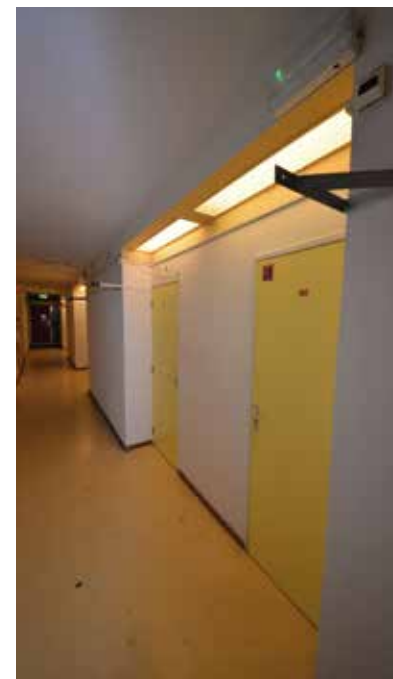
Gang met nissen waarin de deuren geplaatst zijn naar de voormalige zusterkamers in de woontoren. Dit is een voorbeeld van uitgekende detaillering, waardoor de gang een speels karakter krijgt.
