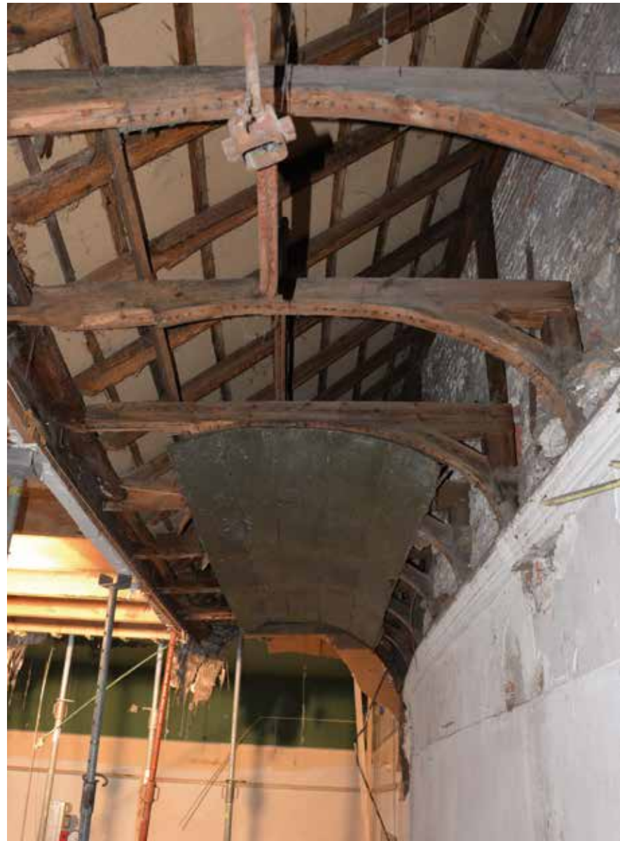
Achter het eikenhouten plafond kwam een gebogen grenenhouten draagconstructie tevoorschijn.
